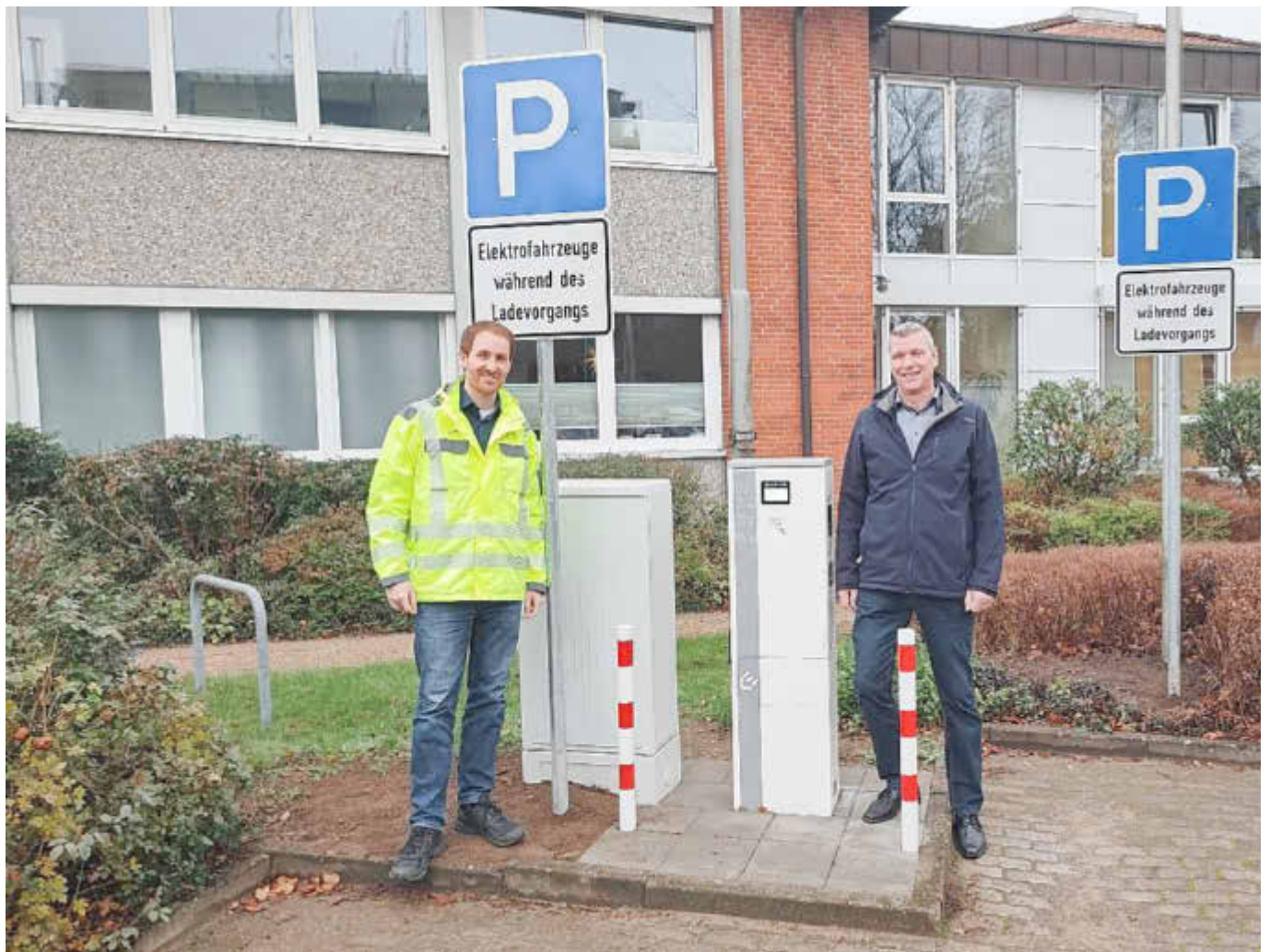
Jascha Winter, Amtstechniker (l.) und Thomas Hartstock, Leitender Verwaltungsbeamter (r.) nehmen die neu installierten E-Ladesäulen in Augenschein. (Bericht: Seite 5)
