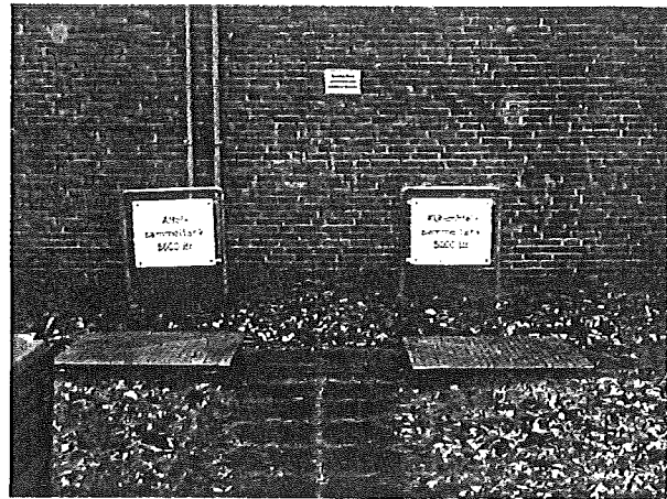
Abb. 1: KVF 2, Altöl- und Altkühlmittelsammeltank (16.04.2002)
