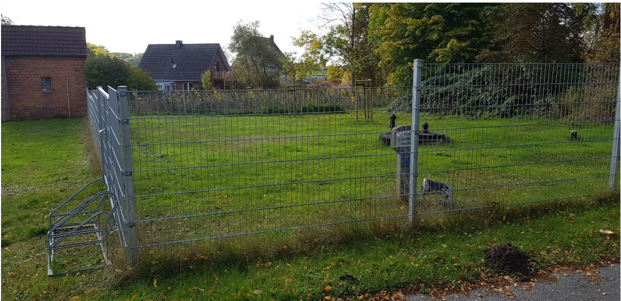
Abbildung 19: Pumpstation (Quelle: Büro für Bauleitplanung)
